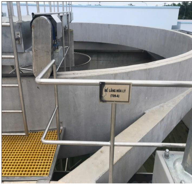
Bể lắng hóa lý (T09-A)
