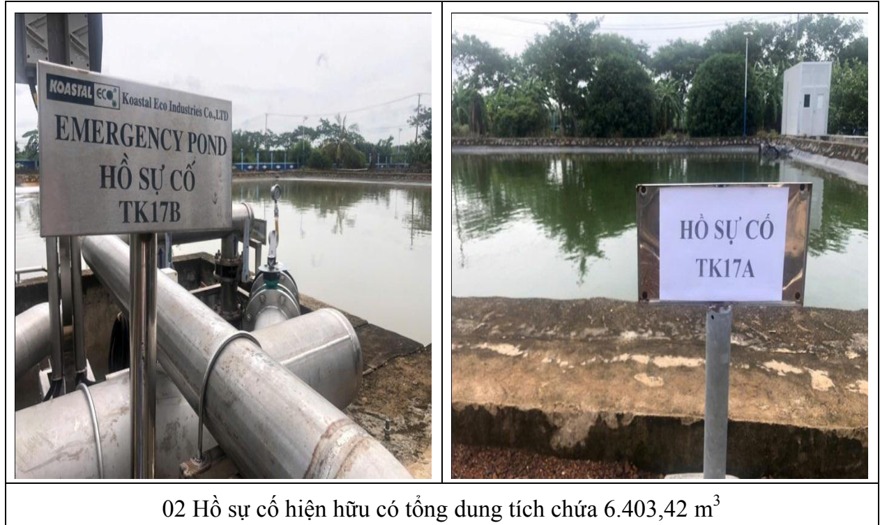
Hình 14. Hồ sự cố của KCN Đất Đỏ I
