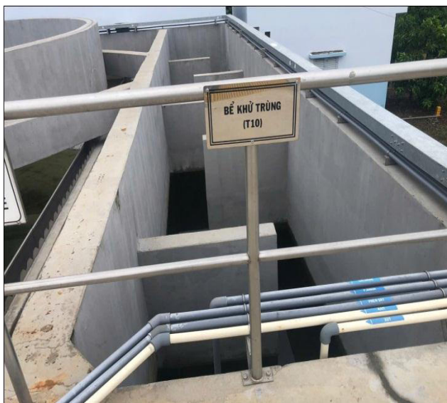
Bể khử trùng (T10)
