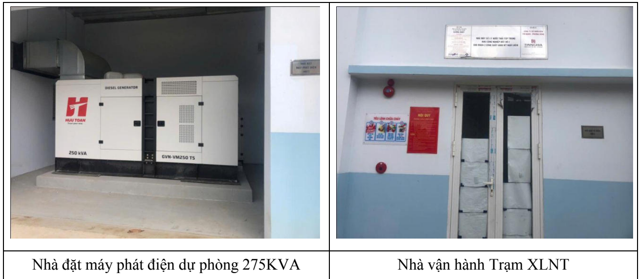
Hình 5. Hình ảnh hệ thống xử lý nước thải Module 2 – Công suất 6.000m 3 /ngày đêm
