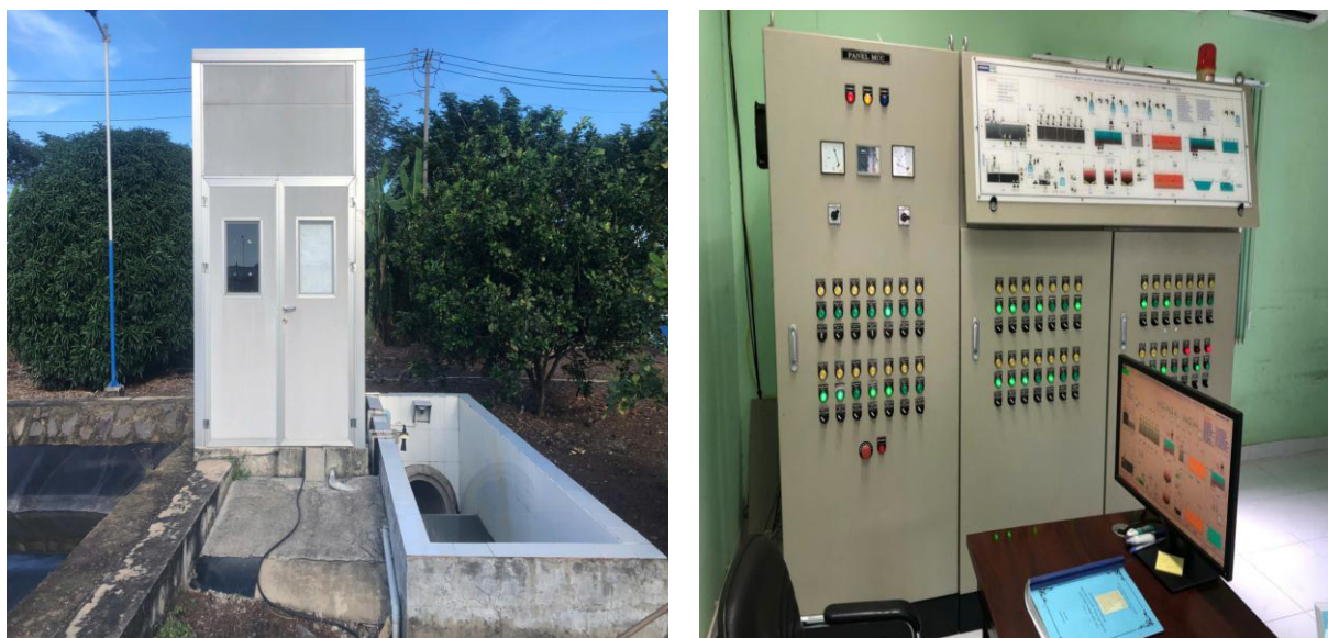
Hình 3. Trạm quan trắc tự động và phòng vận hành Trạm xử lý nước thải
