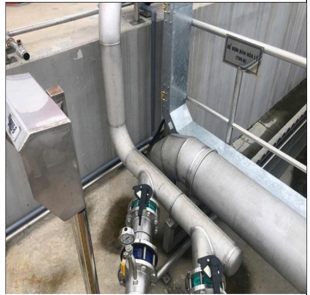
Bể bơm bùn hóa lý (T09-B)
